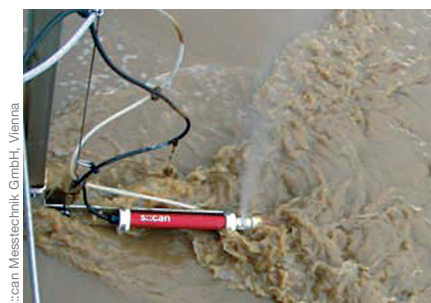
nitro::lyser™ installato in ingresso WWTP
